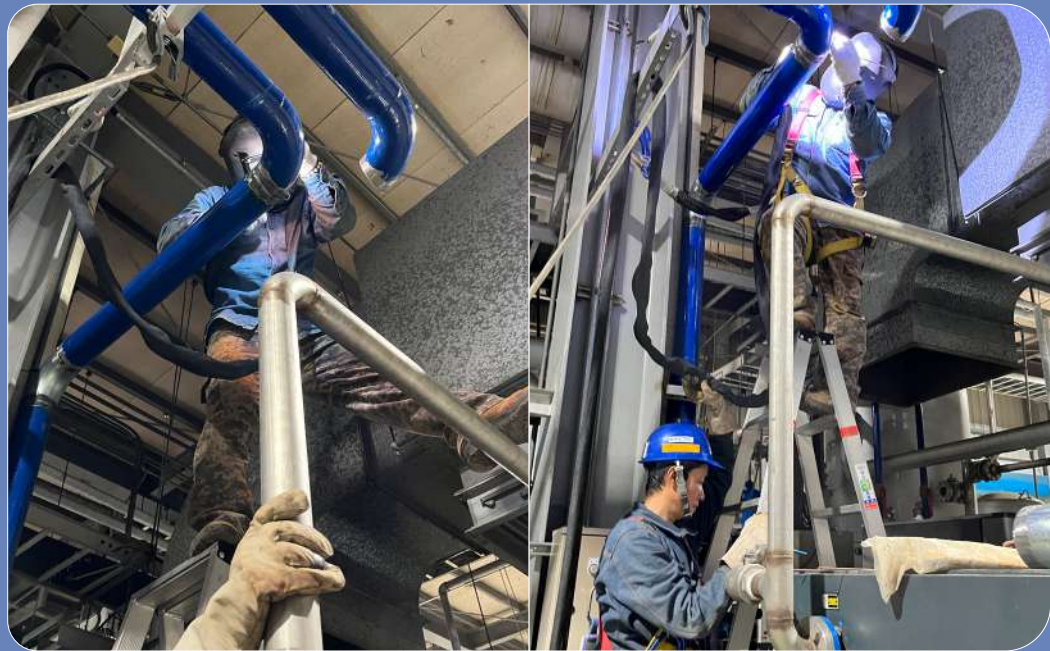
▲ 承攬商作業時踩踏於水管上，監工立即制止並要求改善，待確認安全措施落實後方可繼續作業
